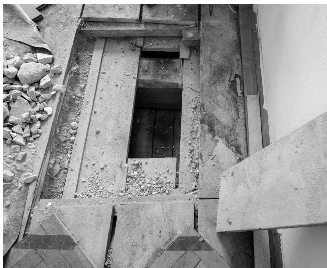
Der Fußboden im Aufzugraum wurde geöffnet, um Informationen über die Beschaffenheit des Bodens, das Auflager der Träger und die Decke des Erdgeschosses zu erhalten. Insbesondere war es wichtig zu klären, welche Art von Schüttung im Boden verwendet wurde und in welchen Abständen die Balken angeordnet sind. Diese Informationen sind notwendig, um die Statik zu berechnen und festzustellen, wie viele Personen pro Quadratmeter stehen dürfen. Foto: Kollektiv Fischka / Kramar
