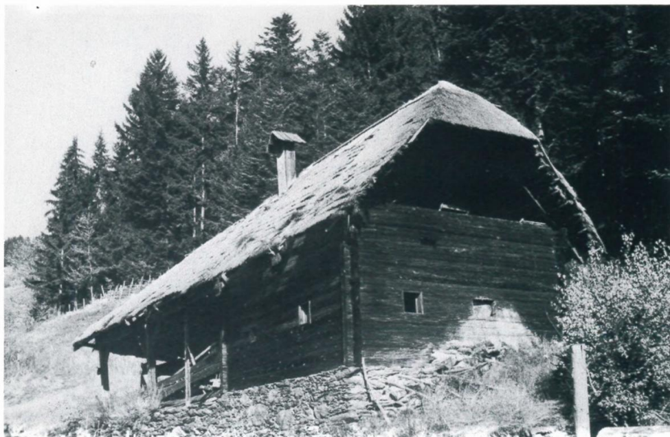
Abb. 6: Die Haarstube des Besitzers Reitbauer, vlg. Oberer Hofstätter, Sonnleitberg bei Gasen, wurde nicht ausgebaut. Das vorlaubenartig vorgezogene Dach und der hölzerne Rauchfang sind gut erhalten.
