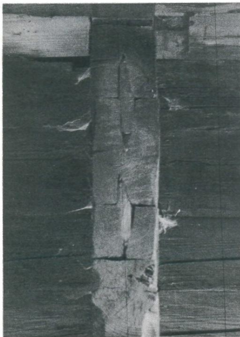
Abb.4: vlg. Treidler, KO 50, 1811: Verdübelung der Blockbaubalken, die durch das Kürzen der Konsolhölzer sichtbar geworden ist.
